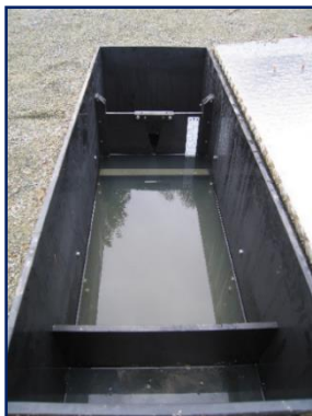
Bac de mesure et de prélèvements en sortie de station
