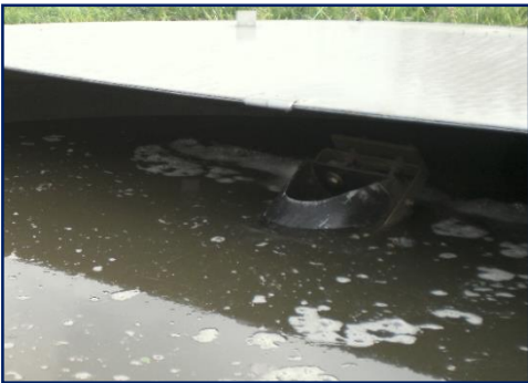
Chasse pendulaire du 2 ème étage, auget flottant en position haute
