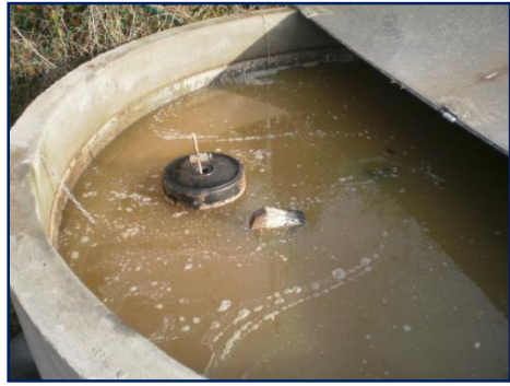
Chasse à clapet du 1 er étage, Flotteur en position haute
