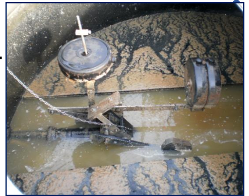
Chasse à clapet du 1 er étage, en fin de bâchée
